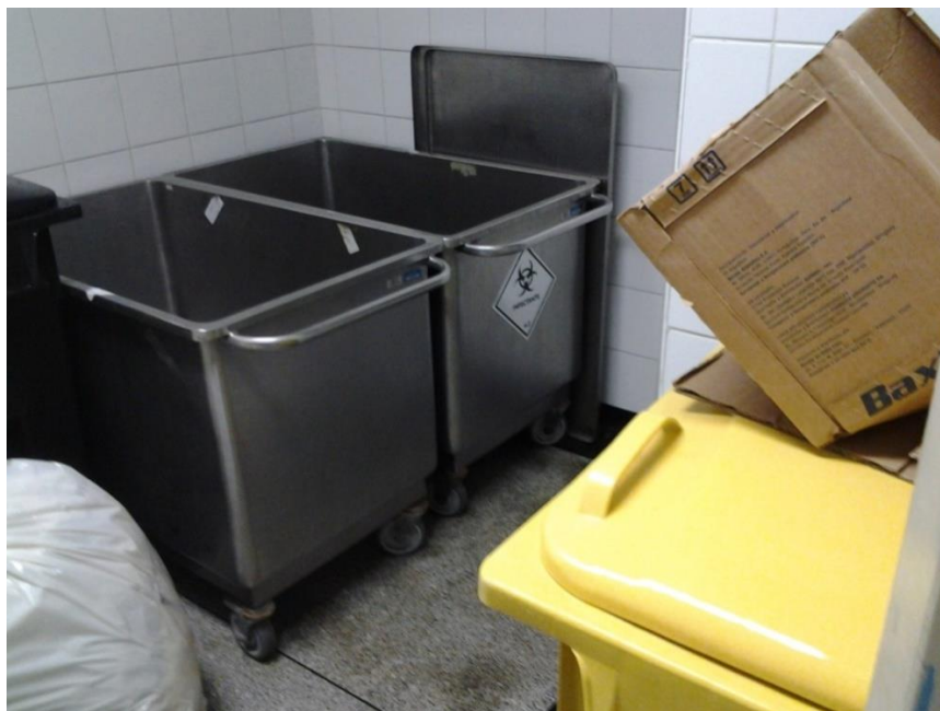
Figura 4.4 – Abrigo interno do Hospital Estadual Mario Covas Fonte: Fotografia retirada pelo autor desta tese.
