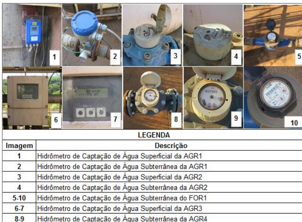
Figura 27 Hidrômetros para aferição do consumo de água
