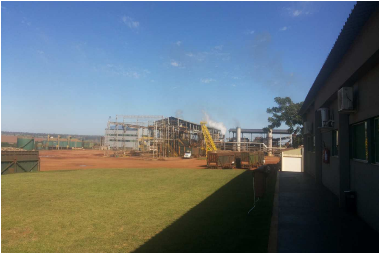
Figura 16. Instalações Industriais de Empresa Sucrialcooleira I
